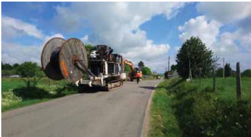
Exemple de chantier d'enfouissement de câble le long d'une voirie (source : sciepd)
